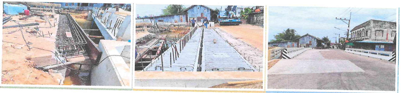
23.โครงการขุดวางท่อระบายน้ำ คสล. บริเวณถนนสายหลังโรงเรียน นูร์ุดดิน ชุมชนตาบาตะปอเยาะ งบประมาณ 17,400 บาท
