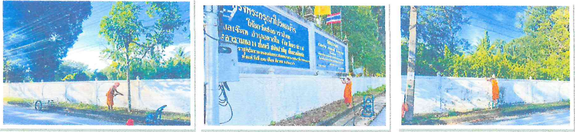
๗๔. โครงการปรับปรุง ซ่อมแซม ทาสีรั้ว กำแพงวัดชลธาราสিংเหฯ (งบประมาณ ๑๐๐,๐๐๐.-บาท)
